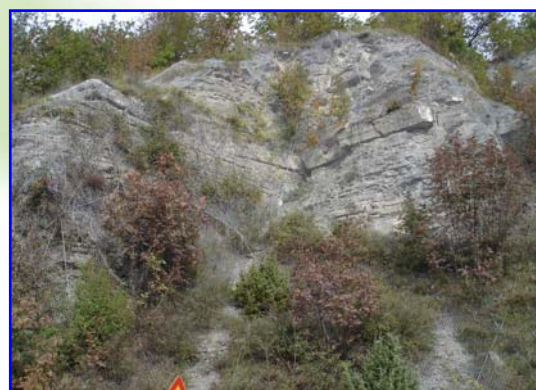
Foto 7 – Intervento paramassi a presidio della S.S.610 "Montanara" nei pressi di Coniale (FI)
