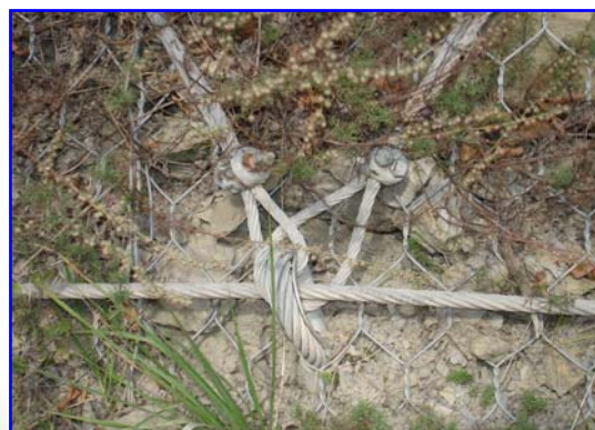
Foto 6 – Dettaglio dell'ancoraggio al piede del sistema paramassi
